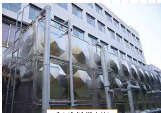
受水槽（洗濯室脇）
