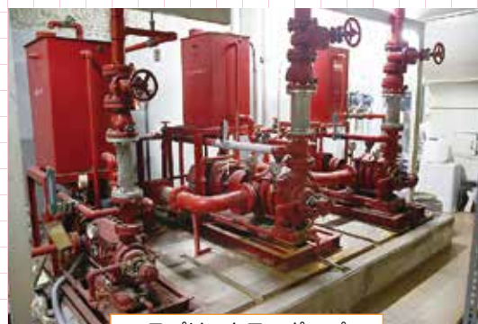
スプリンクラーポンプ
